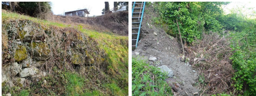
Figure 10 Mur de blocs non cimentés (à gauche) et secteur en voie d'embuissonnement utilisé comme dépotoire (à droite).
