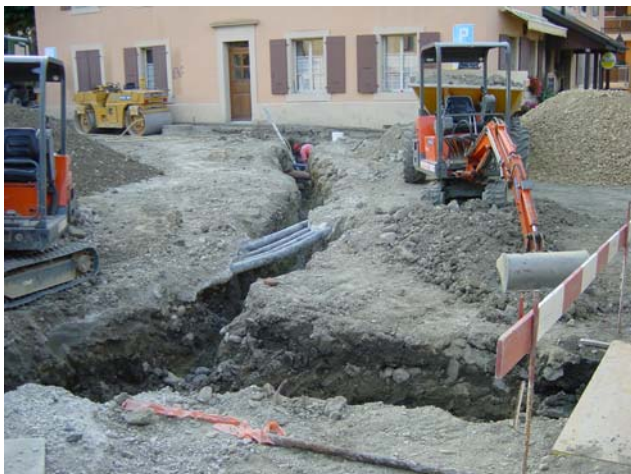
Conduites de chauffage en attente Auberge et Grande salle
